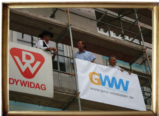
Kletterten für den Richtspruch gemeinsam aufs Gerüst: der Polier, GWW-Geschäftsführer Dr. Mathias Müller und der Bauunternehmer (v. l. n. r.).
